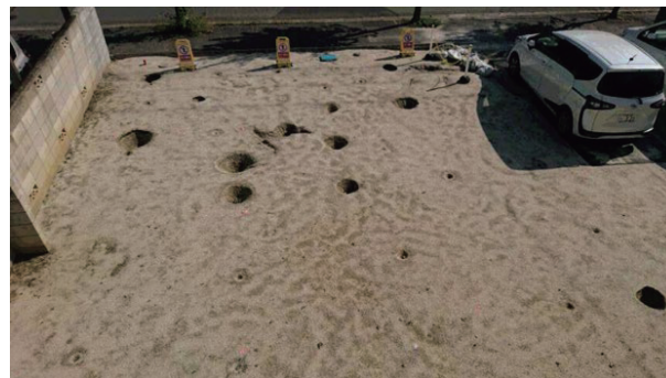
図-1 沈下の発生事例
